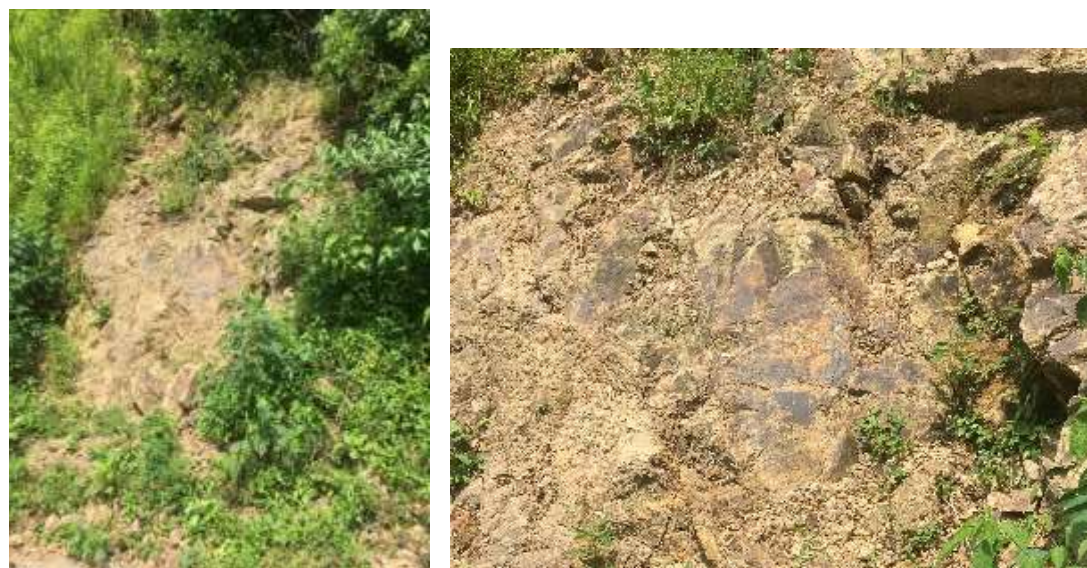
写真 2-②-1 岩屋川の最上流付近の崖の地層：流紋岩、デイサイト
